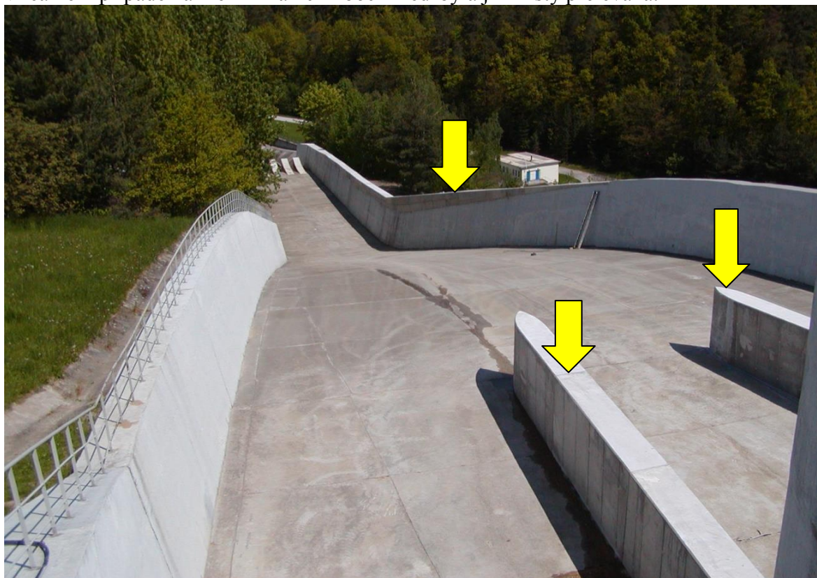
Obr. 1 VD Římov - navýšení části zdi skluzu od bezpečnostního přelivu a prodloužení rozdělovacích pilířů jednotlivých polí bezpečnostního přelivu
