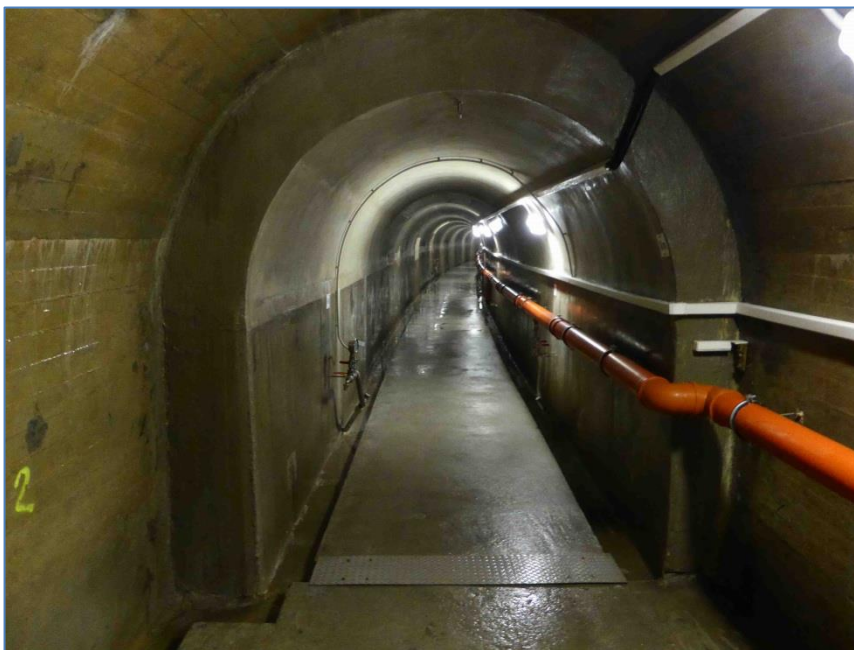
Obr. 7 Pohled na dokončenou injekční štolu II. etapy od odbočky přístupové štoly z I. etapy
