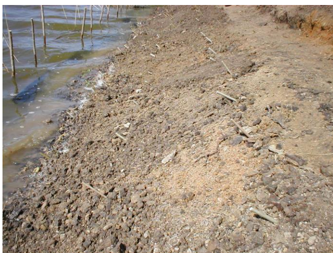
Obr. 3 Po osazení geosítě zasuneme vrbové řížky délky přibližně 0,4m ve sponu cca 0,4m x 0,4m tak, aby 1/3 řížku vyčnívala nad terén. Po následném zasypání vrstvou zeminy 3 – 5 cm vyčnívá asi 7 cm řížku s jedním či dvěma očky.
