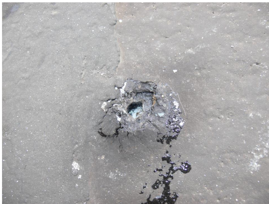
Obr. 1: Porucha asfaltbetonového těsnění (fotoarchiv M. Špano)
