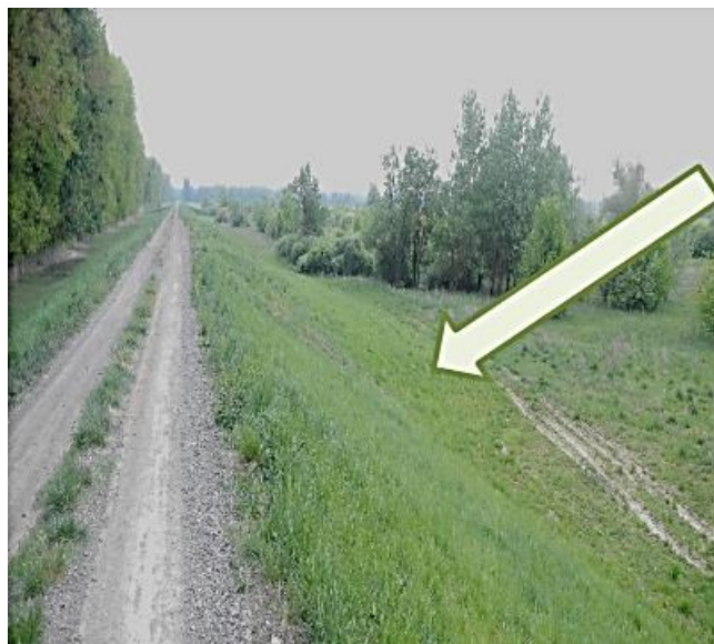
Obr. 3 Pohľad na poruchu hrádze na vzdušnej strane
